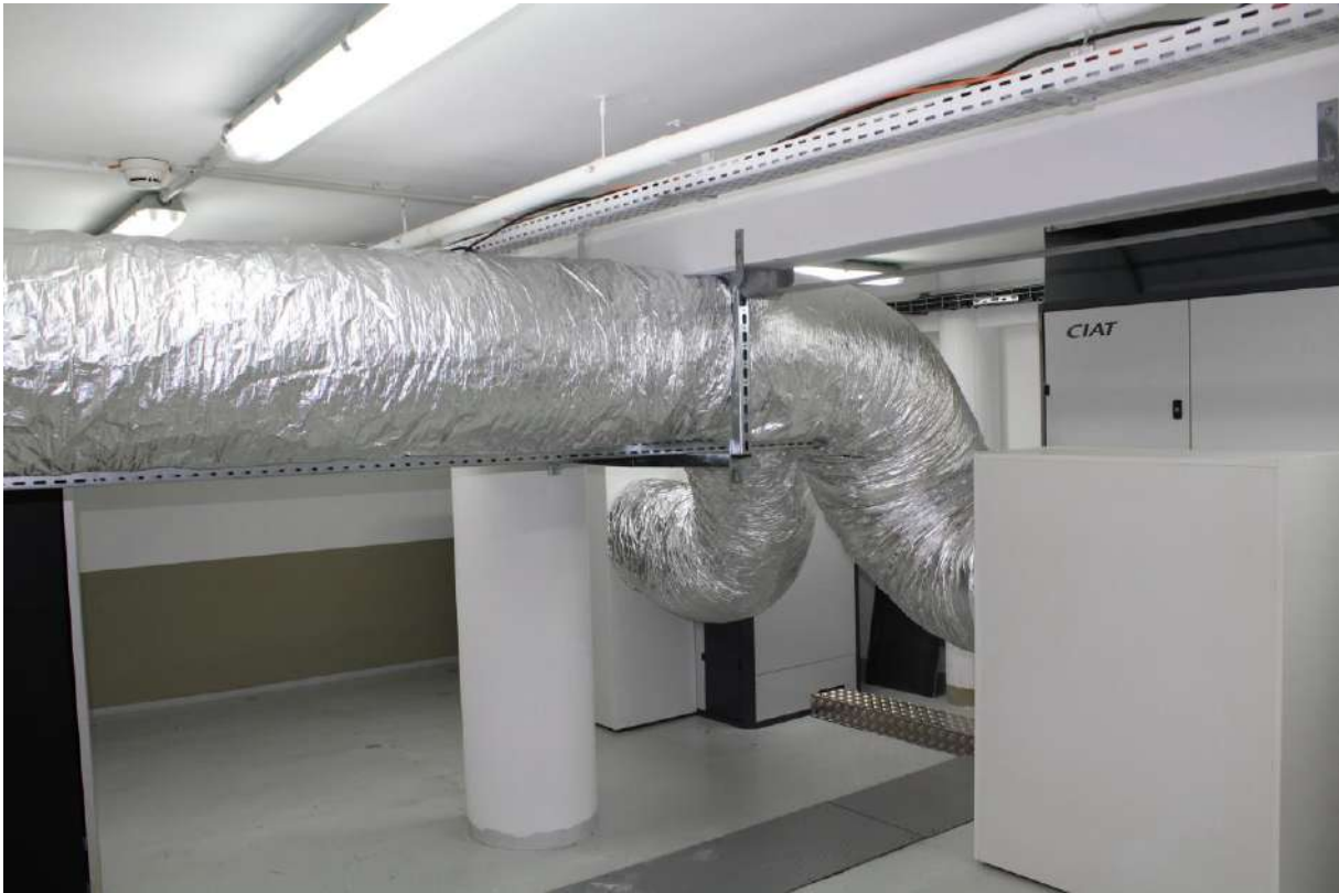
Figure 19. Climatisation de la salle du mésocentre, partie froide
