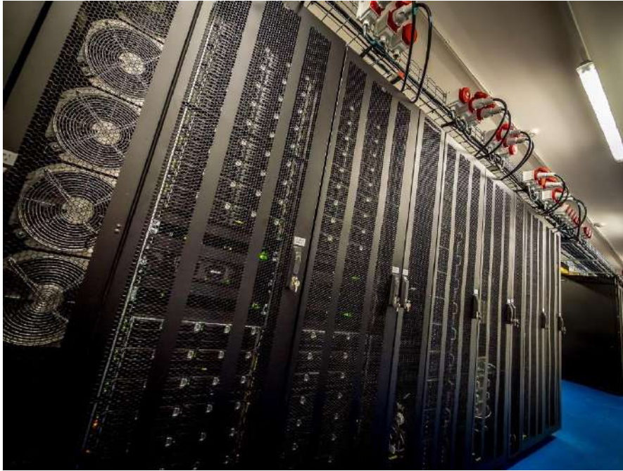
Figure 14. Armoires et baies du datacenter uB
